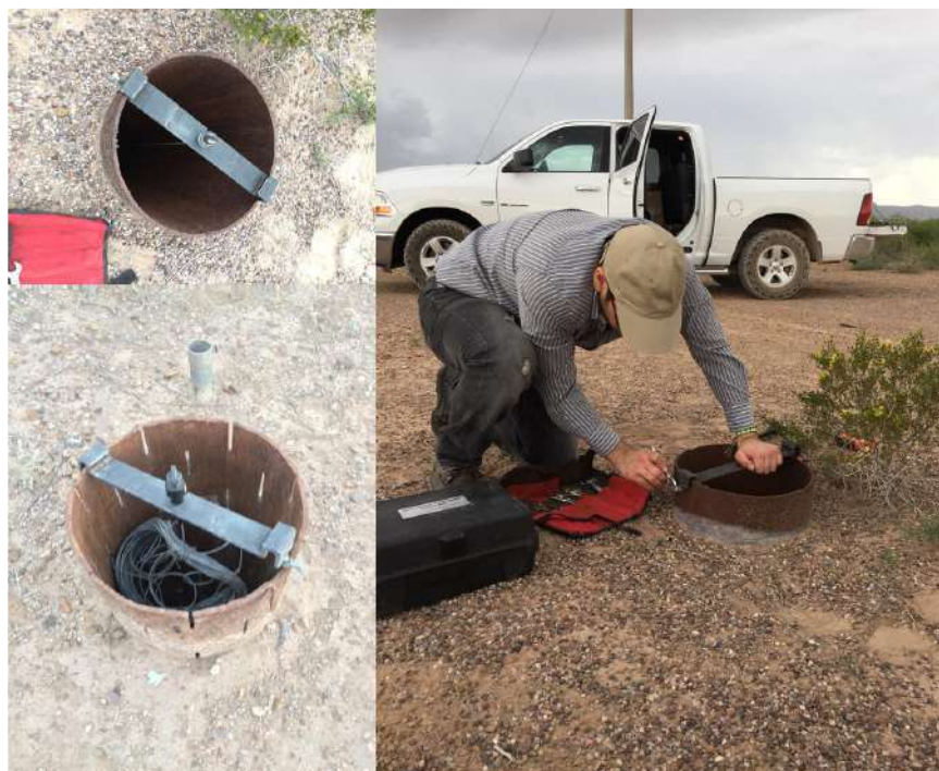
Figura 5. Instalación de piezómetros digitales sobre la infraestructura del pozo (Romero-Gameros, 2018). Figure 5. Installation of digital piezometers over well infrastructure (Romero-Gameros, 2018).
