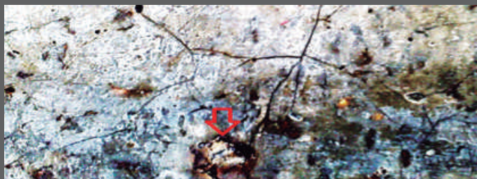
Figura 1. Agrietamientos en el concreto y evidencia del gel producto de la RAA.
