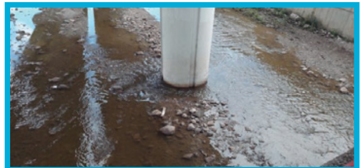
Figura 1. Columna después del paso del agua de lluvia.
