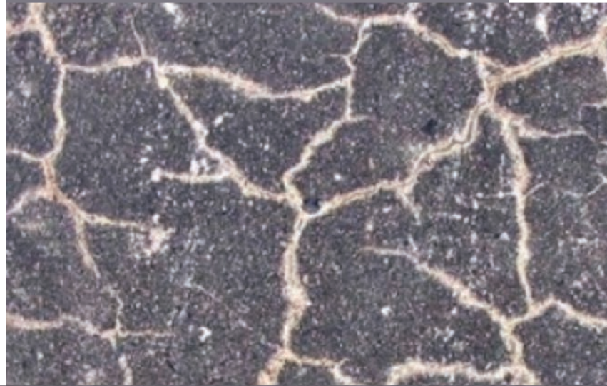
Figura 2. Agrietamientos reparados con la acción de bacterias.
