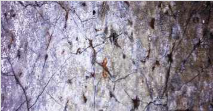
Figura 1. Fisuramiento en el concreto producto de la RAA.
