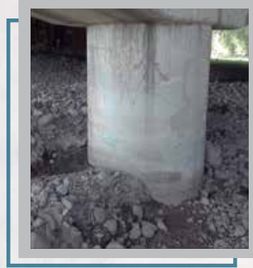
Figura 1. Se muestra el inicio de la socavación en una columna.
